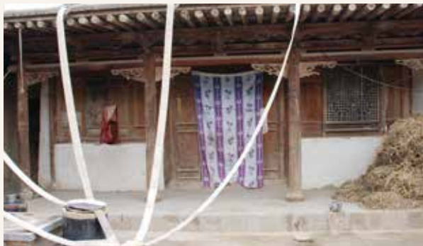
以前，村民将屋顶的雨水引流灌入水窖中以供使用
