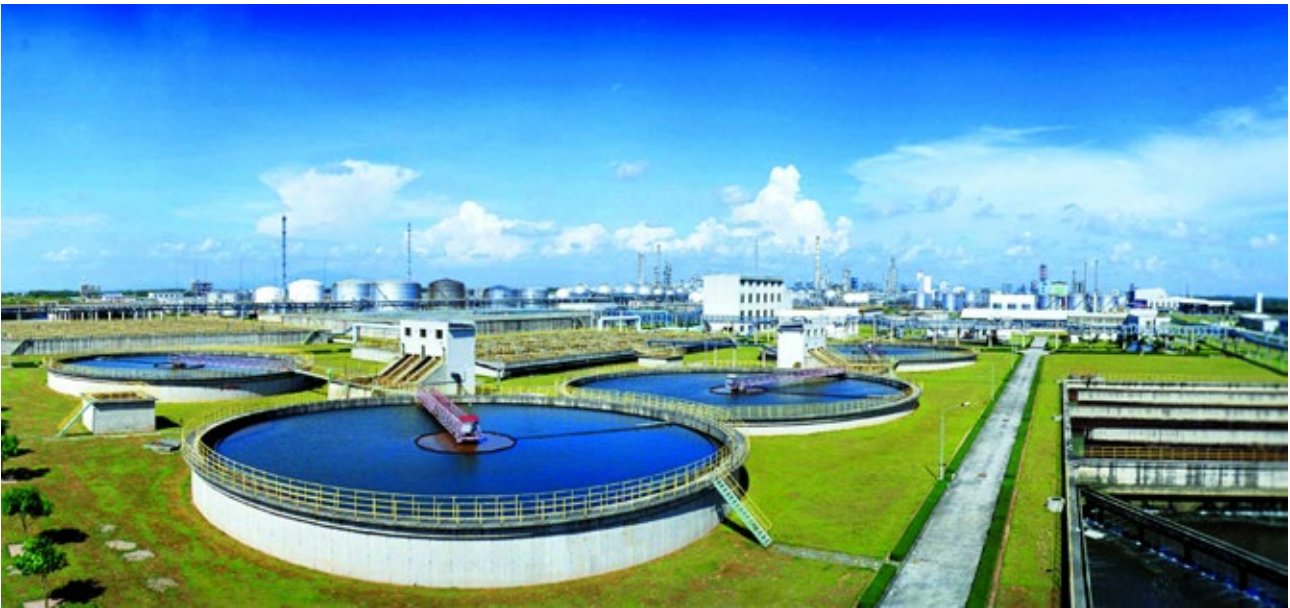
中国石化茂名石化乙烯污水处理装置
